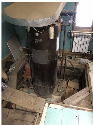
Рис. 1 – Твердотопливный котел «Liepsnele» мощностью 20 кВт, установленный в частном доме микрорайона г. Якутск
